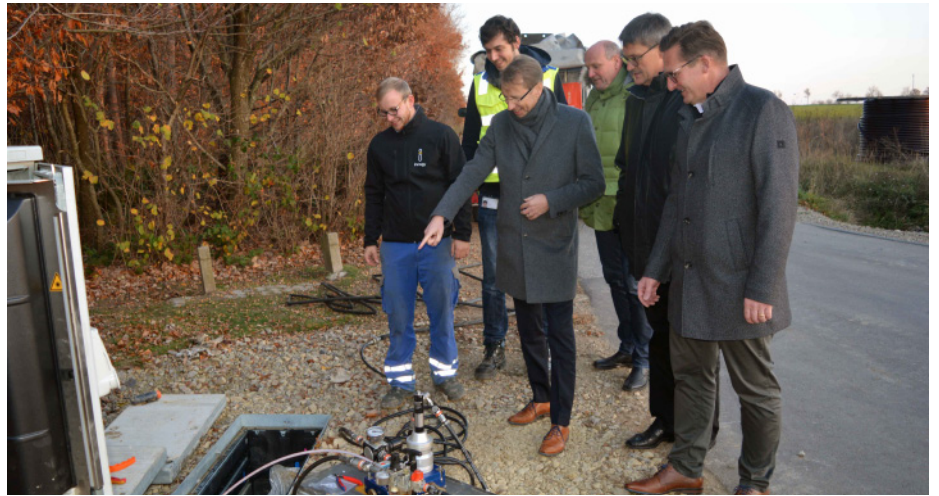
Gemeinsam mit Vertretern vom Energieunternehmen innogy besichtigte Landrat Günther Schartz (2.v.r.) einen Kabelgraben und einen Glasverteilerschrank zum Ausbau des schnellen Internets in der Ortsgemeinde Zemmer.
